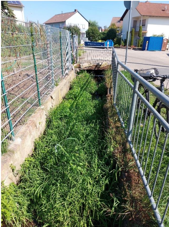
Abbildung 15 Maikammer, Kropsbach im Bereich Gartenstraße, starker Sohlbewuchs
